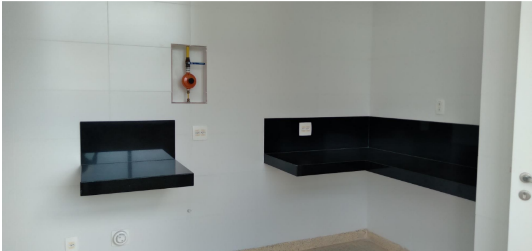
Foto XV: Exaustão da cozinha
