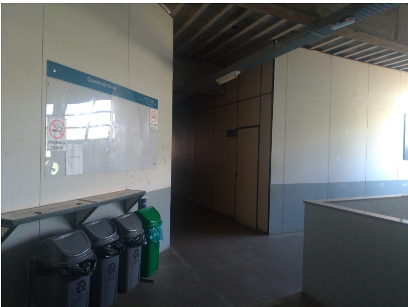
Piso sem cerâmica
