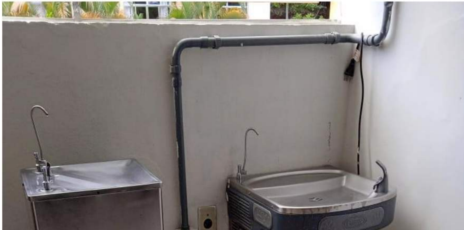
*Bebedouro acessibilidade com defeito
